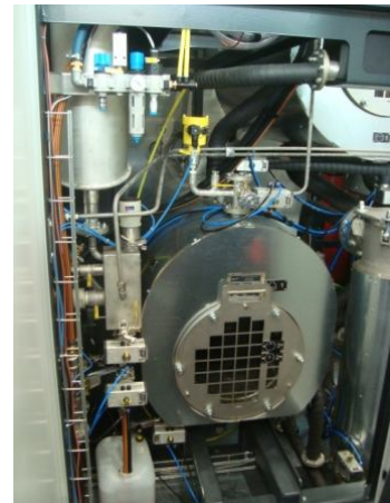
Detalle: sistema de reciclo interno.
